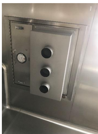
图 4 【IVC 排风管道现场图】
